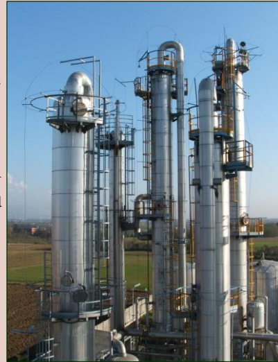
Des tours de distillation
